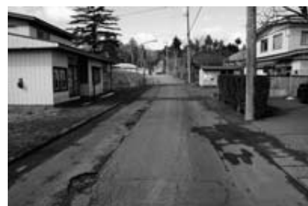
【整備前・和野平井賀線】道幅が狭く、舗装や側溝が傷み、通行に支障があった
